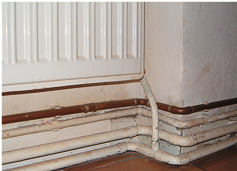
Az ivóvíz-higiéna szempontjából csaknem „végzetes” szerelvény egy régi épületben: Az újonnan lefektetett, szűk, 5 méter hosszúságú csapolóvezeték (15-ös Cu-cső) a vételezési pont hidegvíz-ellátásához csak néhány centiméterrel a fűtőtest előremenő és visszatérő ága fölé helyezték el
