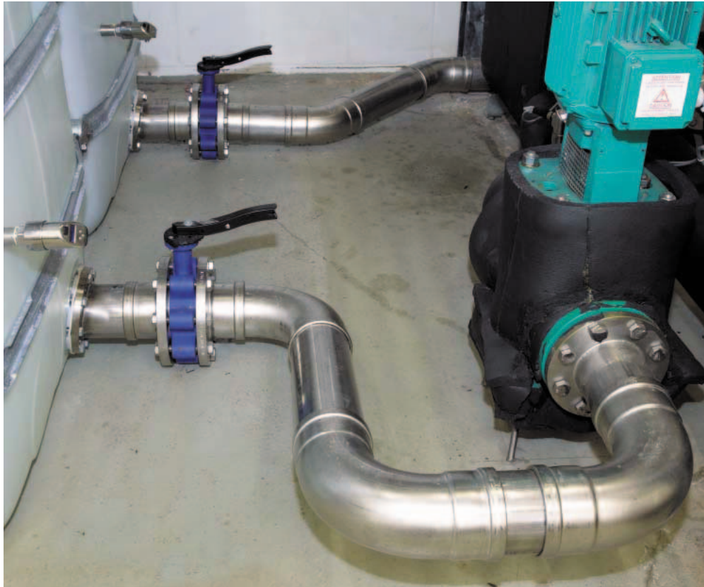
Hűtőkör Sanpress Inox XL-lel: Szerelvények és szivattyúk csatlakoztatása Viega nemesacél karimák segítségével.
