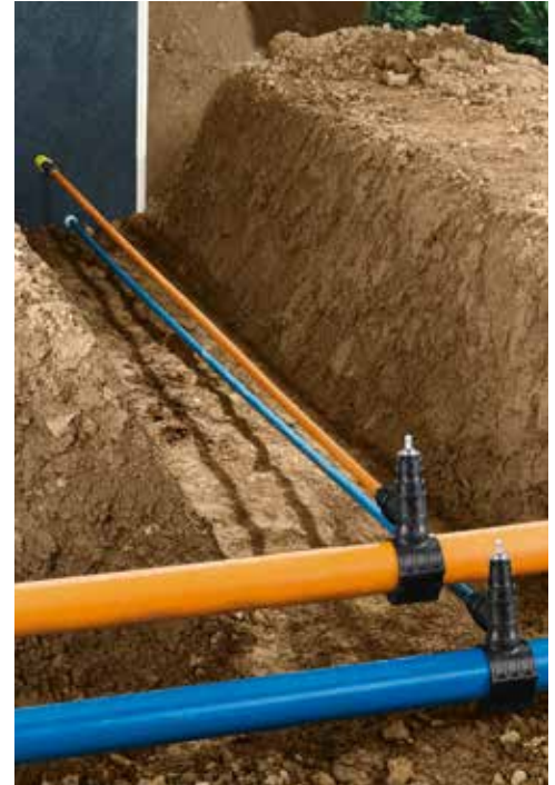
A föld alatt fektetett ivóvíz-, gáz- és hidrogén-elosztóvezetékek megbízhatóak és gazdaságosak.
